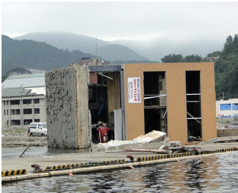
横転して流された3階建てビル（女川町）
